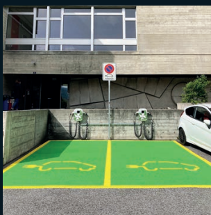
Station de recharge pour véhicules électriques
