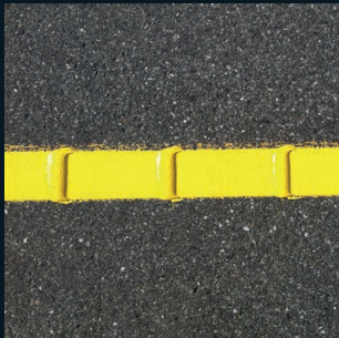
Ligne avec barrettes acoustiques
