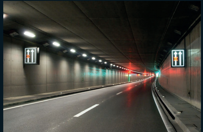
Signalisation lumineuse pour tunnel
